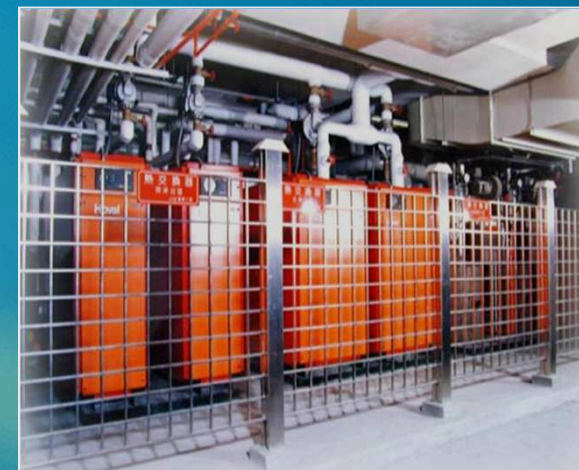
熱交換機系統工程 30
